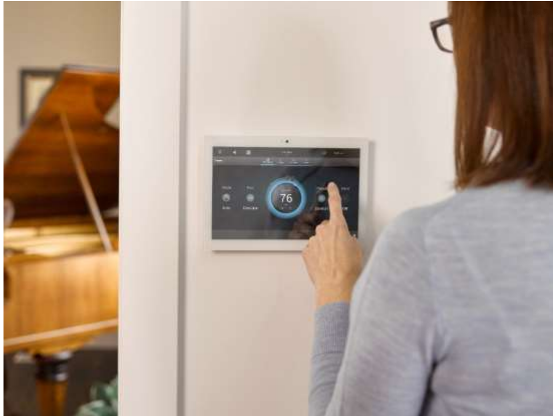
Controlul funcționalităților de Smart Home de pe touch panel
