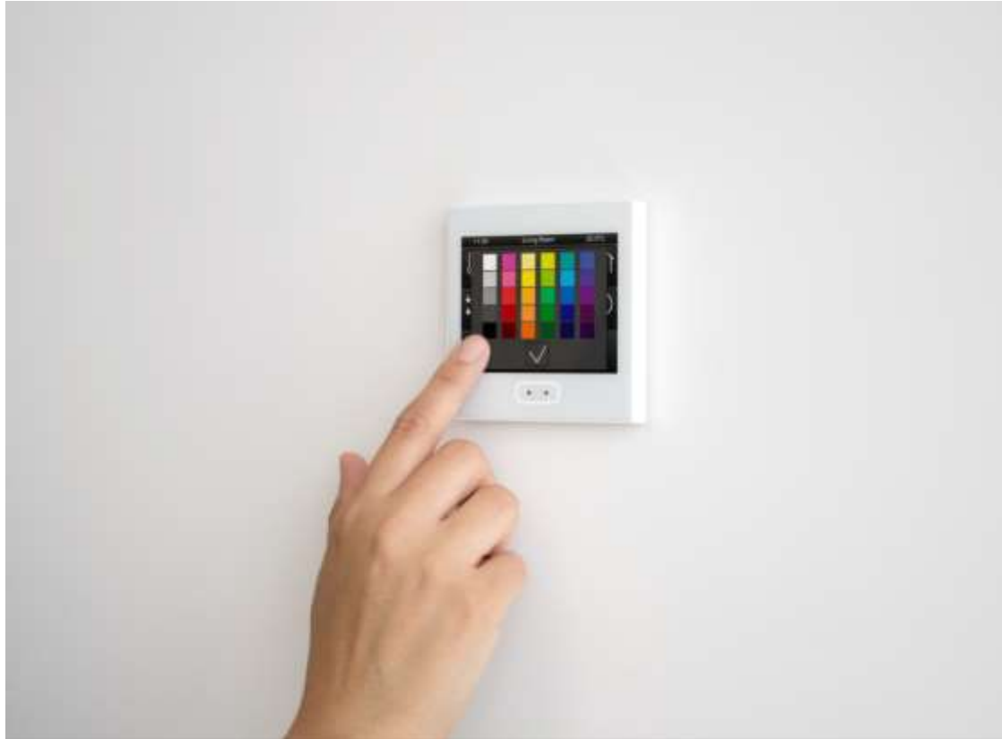
Control iluminat RGB de pe touch panel
